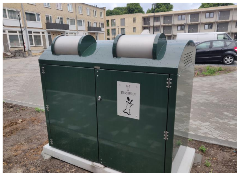
Bovengrondse GFE-verzamelcontainers bij hoogbouw
